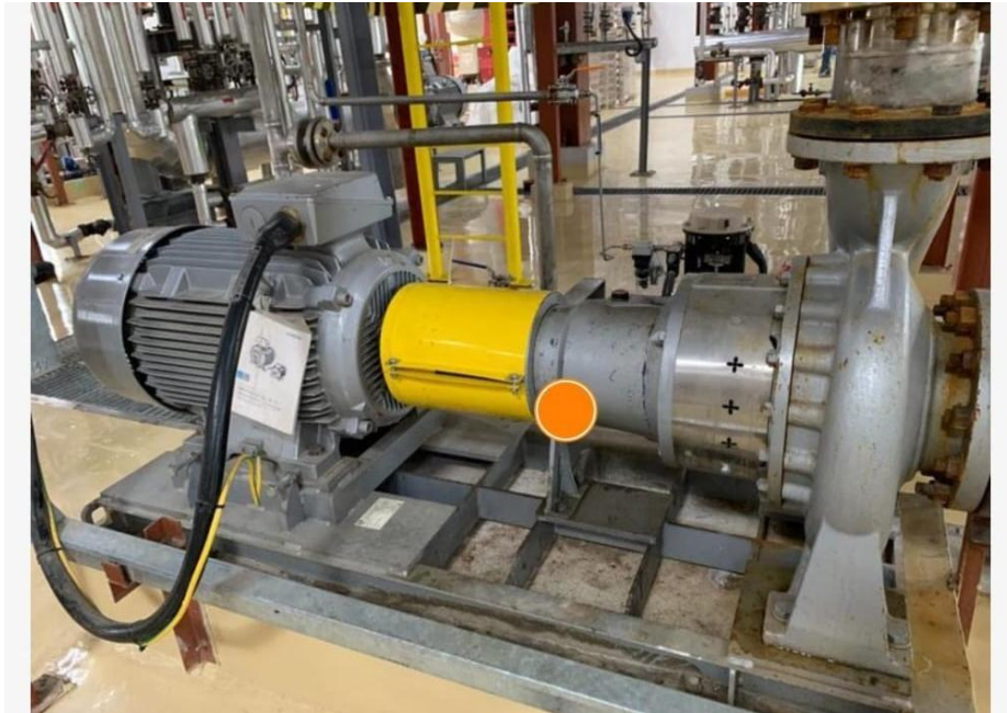
Gambar 2.2 Unit Pompa Sentrifugal di PT Unilever Oleochemical Indonesia (Dokumentasi Perusahaan, 2025)
