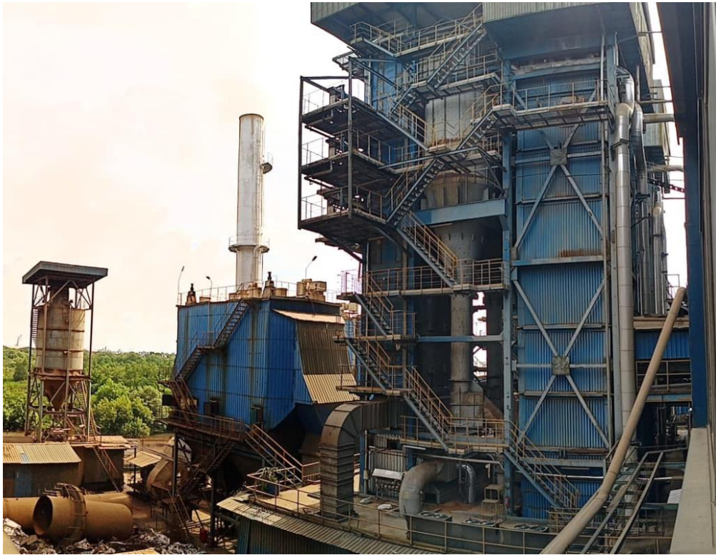
Lampiran 1. Foto Boiler Sistem Pada Siang Hari
