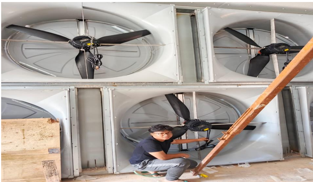
Gambar lampiran 3 blower menggunakan Listrik 3 phasa
