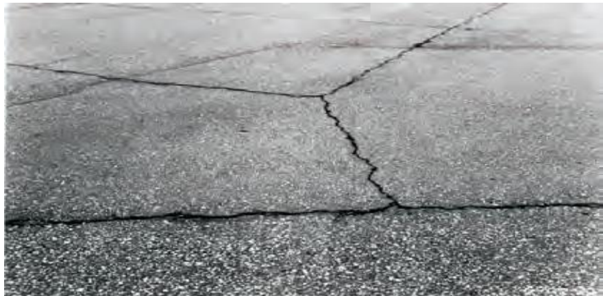
Gambar 27. Retak sambungan jalan Sumber : Shahin, 2003
