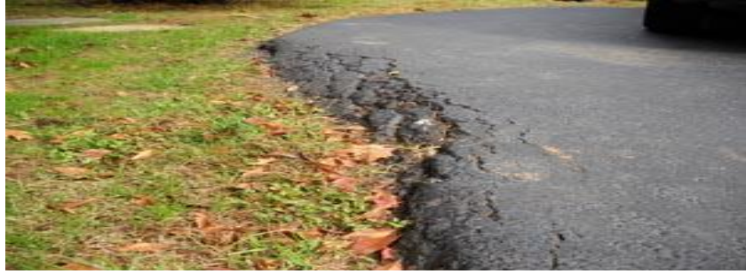
Gambar 26. Retak pinggir Sumber : Shahin, 2003
