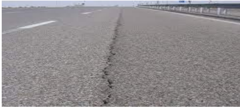
Gambar 28. Retak sambungan pelebaran jalan, Sumber : Shahin 2003
