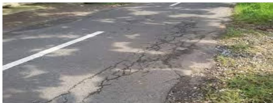
Gambar 42. Penurunan pada bekas penanaman utilitas, Sumber : Departemen Pekerjaan Umum Direktorat Jenderal Bina Marga
