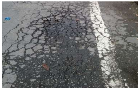
Gambar 2.1 Retak Kulit Buaya ( AligatorCracking ) Sumber : Bina marga no.03/MN/B/1983
