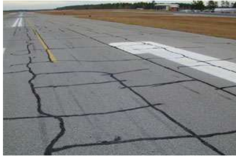
Gambar 2.3 Retak Kotak-kotak ( Block Cracking ) Sumber : Bina marga No.03/MN/B/1983
