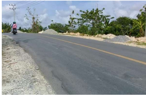
Gambar 2.2 Kegemukan ( Bleeding ) Sumber : Bina marga No.03/MN/B/1983
