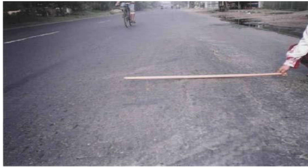
Gambar 2.17 Mengembang Jembul ( Swell ) Sumber : Bina marga no.03/MN/B/1983
