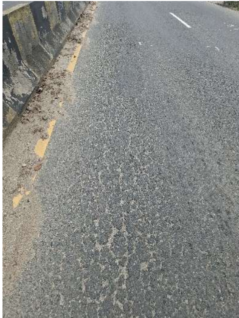
Retak Buaya ( Aliigator Cracking )
