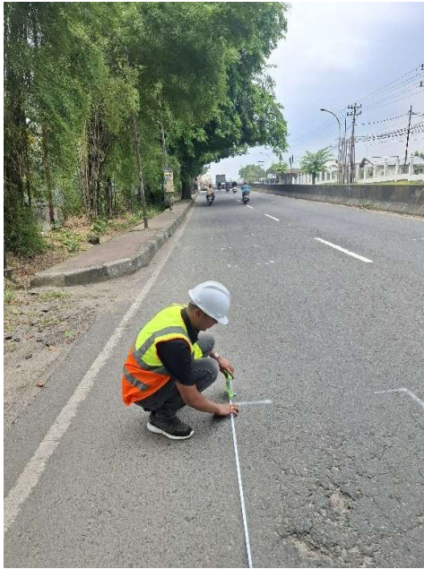
Pengukuran Luas Kerusakan Jalan
