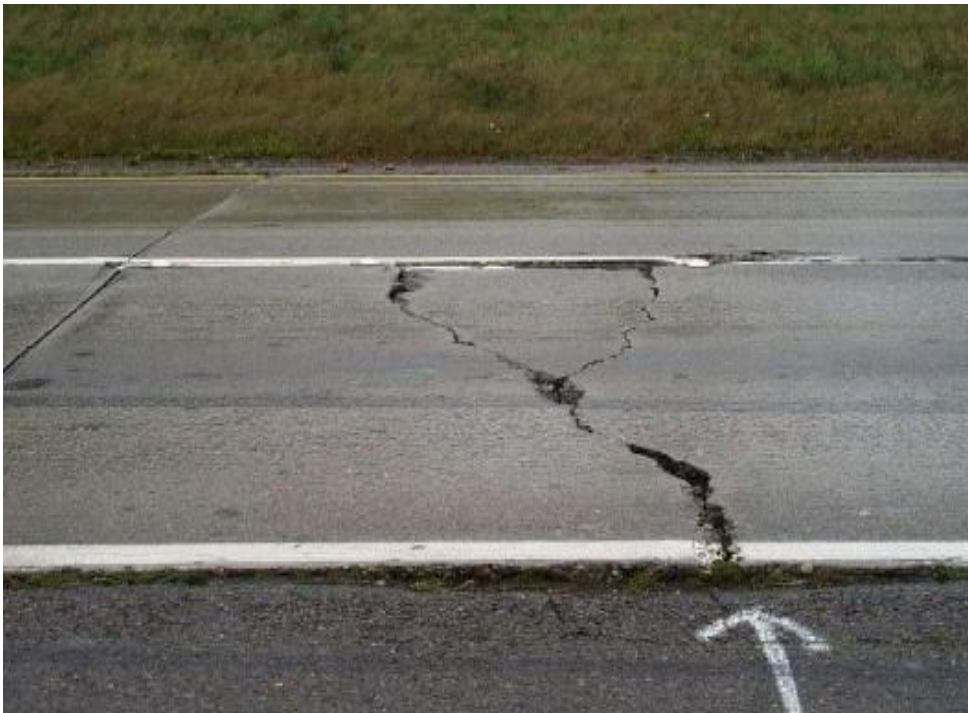
Gambar 2.6 Retak Sambungan Jalan
