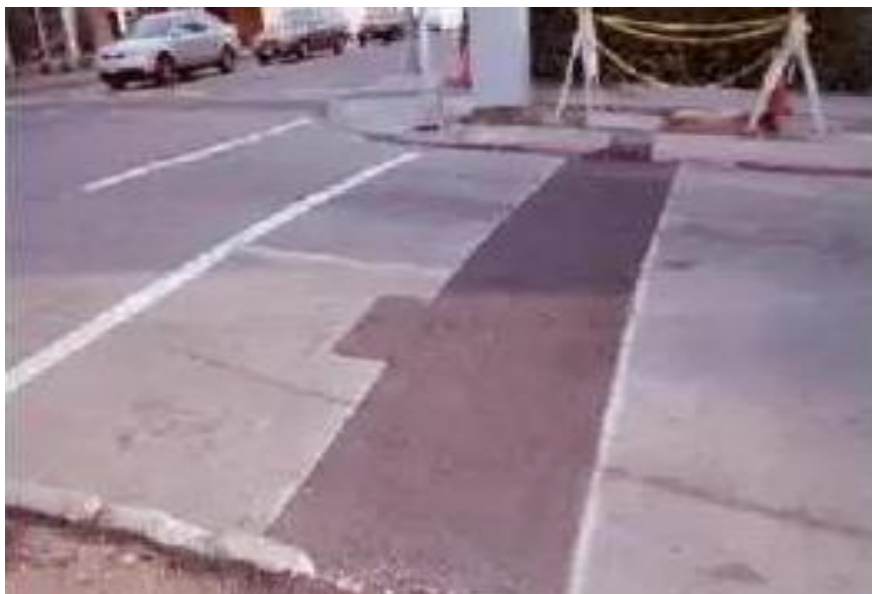
Gambar 2.21 Penurunan Pada Bekas Penanaman Utilitas
