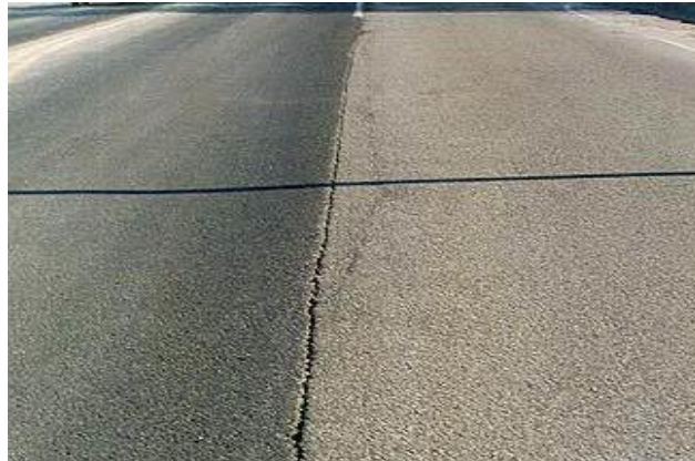
Gambar 2.7 Retak Sambungan Pelebaran Jalan
