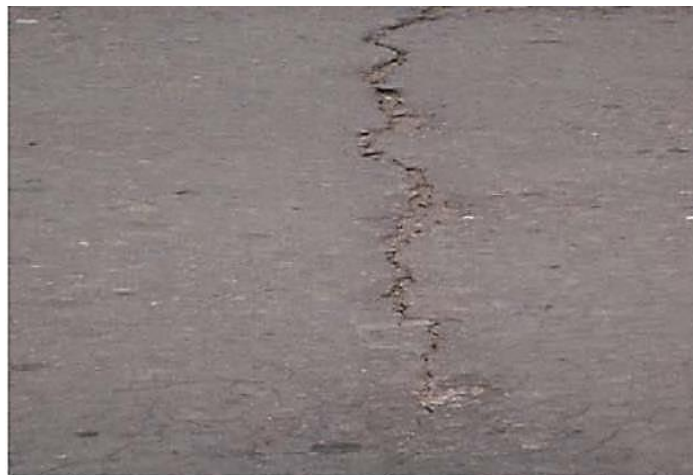
Gambar 2.8 Contoh Penurunan pada Bahu Jalan ( Lane/Shoulder Drop Off )
