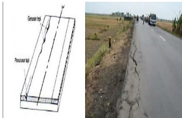
Gambar 2.6 Contoh Kerusakan Retak pinggir ( Edge Cracking )
