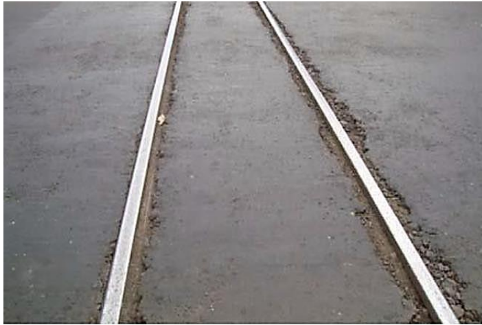
Gambar 2.13 Contoh Kerusakan Perlintasan Jalan Rel
