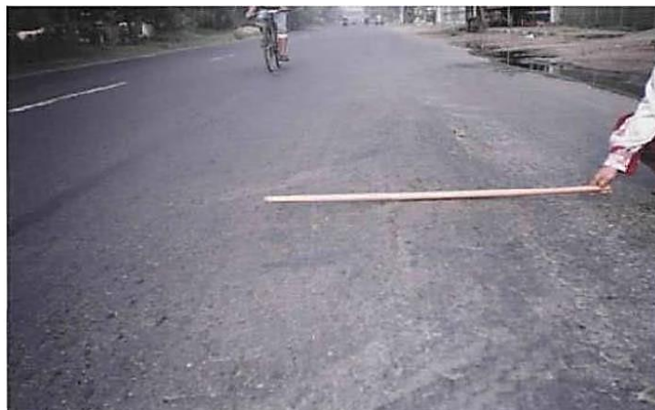
Gambar 2.15 Contoh Kerusakan Mengembang ( Swell ) (Sumber : Bina Marga no.03/MN/B/1983)
