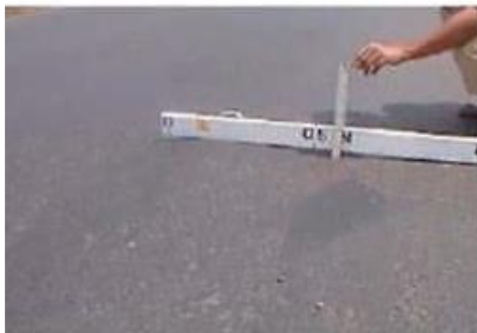
Gambar 2.13 Contoh Kerusakan Alur ( Rutting )
