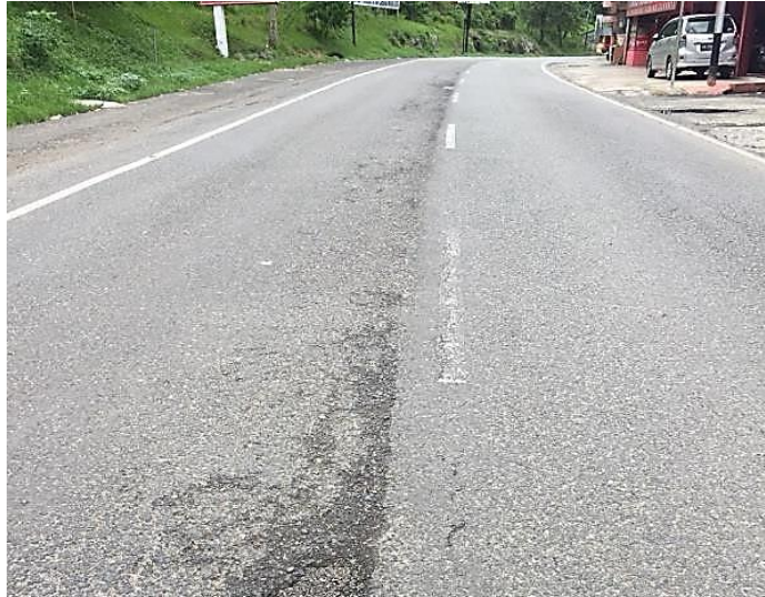
Gambar 2.9 Contoh Kerusakan Retak Memanjang dan Melintang
