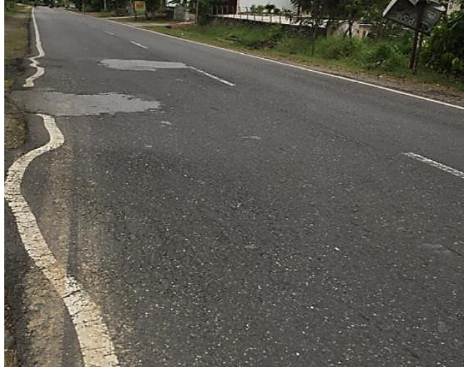
Gambar 2.5 Contoh Kerusakan Amblas ( Depression )
