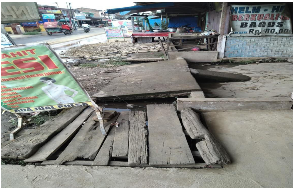
Gambar 6. Kondisi saluran drainase bagian kanan
