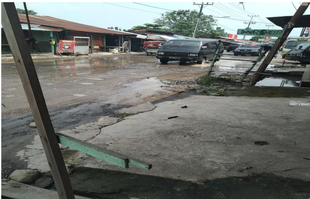
Gambar 4. Genangan air yang terjadi akibat air yang meluap dari saluran drainase
