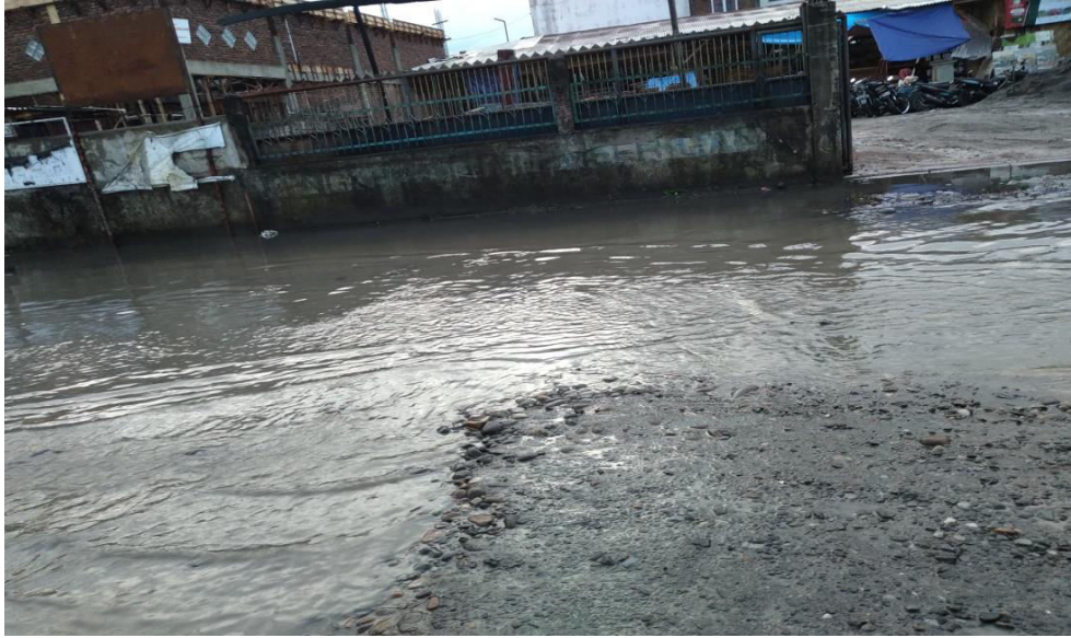
Gambar 11. Genangan air/banjir yang terjadi setelah hujan
