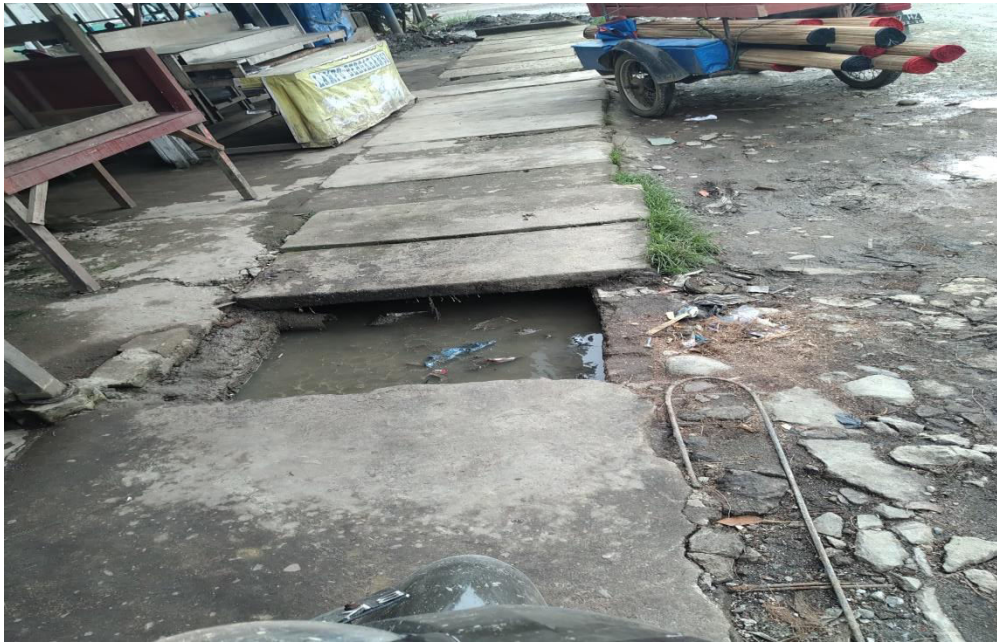
Gambar 5. Kondisi saluran drainase bagian kanan
