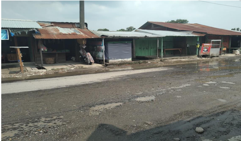
Gambar 3. Jalan rusak akibat drainase yang tidak layak
