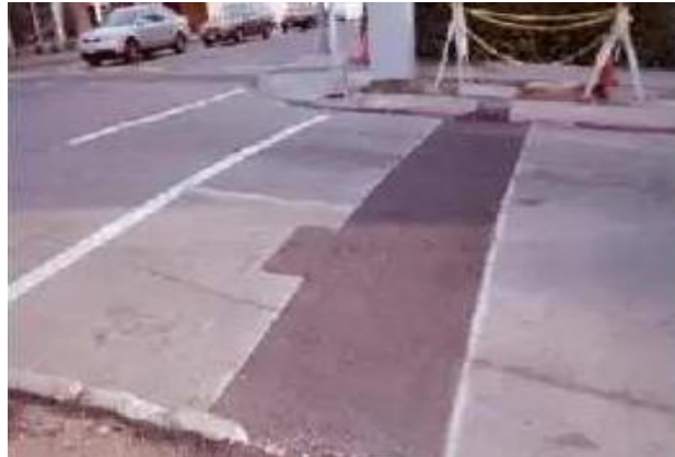
Gambar 2.21 Penurunan Pada Bekas Penanaman Utilitas
