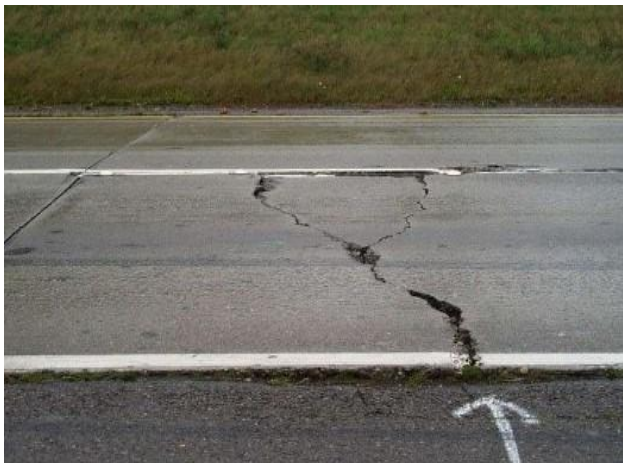
Gambar 2.6 Retak Sambungan Jalan
